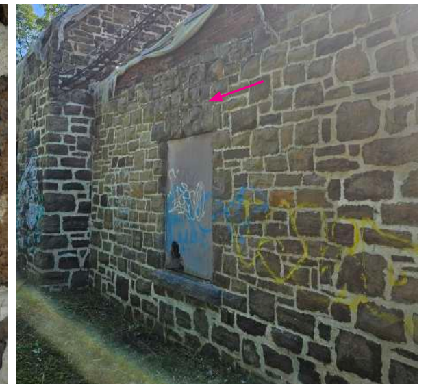
6_Mur de l'aile ouest. Dommages des pierres dues à l'incendie de 2012.
