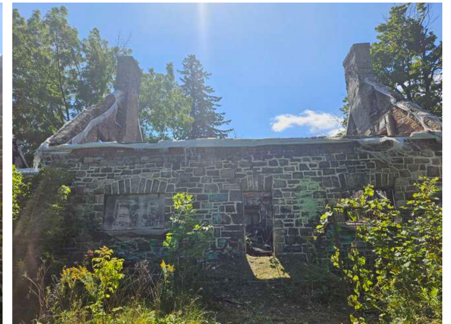
5_Façade Nord. Avant l'incendie, le toit à deux versants était couvert de bardeaux d'asphalte.
