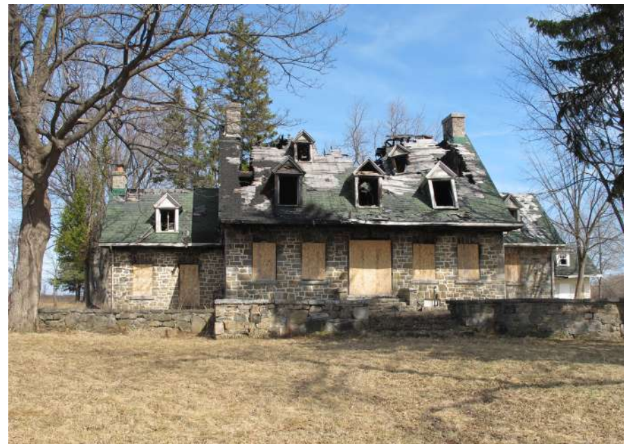
2_État de la maison en 2014 après l'incendie de 2012. (Source: Lafontaine et Soucy, 2014)
