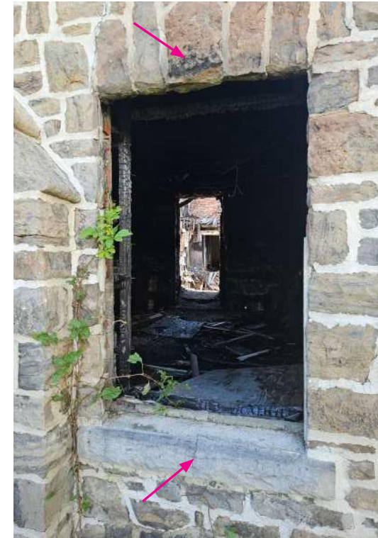
2_Ouverture de fenêtre sur la façade ouest. Présence de fissure dans l'allège et calcination des pierres de tête due à l'incendie de 2012.
