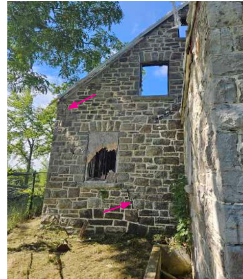
3_Mur du corps de l'aile est. Larges fissures causées par l'écoulement d'eau sur la façade
