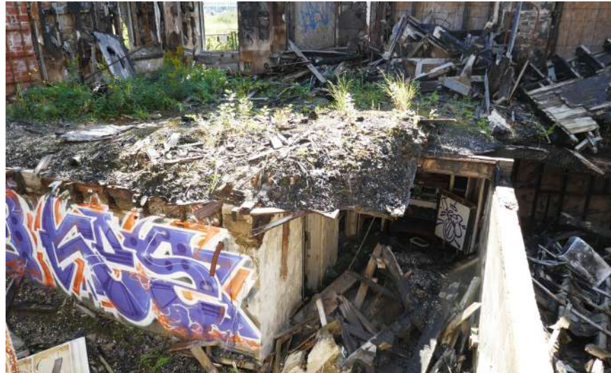
2_Plancher effondré du bâtiment principal.
