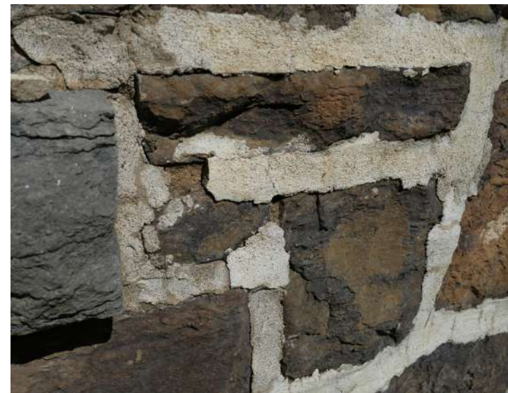
5_Rejointoiements successifs de la maçonnerie réalisés avec des mortiers inadéquats et parfois en projection de la surface de la pierre, facteur provoquant notamment la pénétration de l'eau de pluie à l'intérieur de la maçonnerie et sa dégradation. (F. Goulet, 2018)
