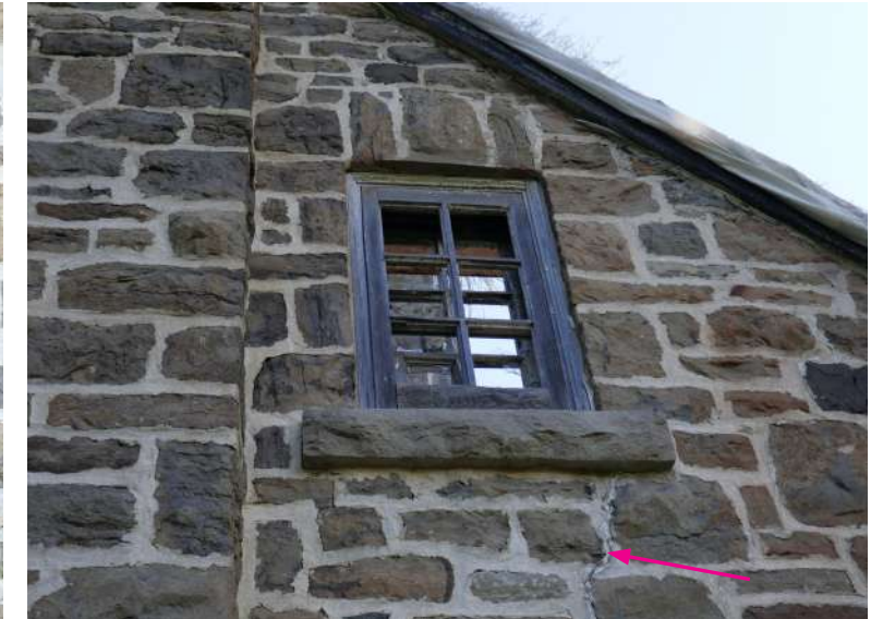
3_Cadre de fenêtre d'origine à l'étage et fissuration de la maçonnerie avec réparation inadéquate.
