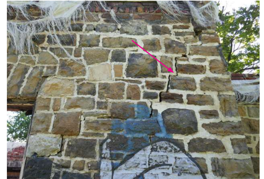
4_Façade Nord - large fissure suggérant un mouvement des fondations.
