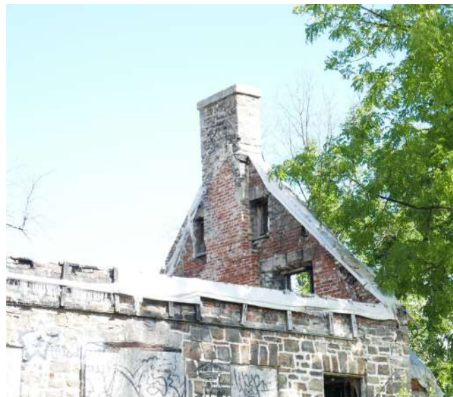
3_Cheminée mur est et protection défailante aux têtes de murs.
