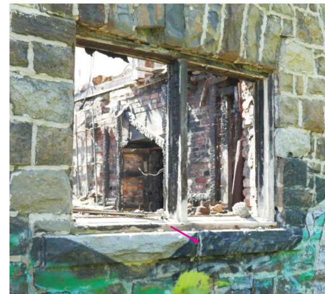
4_Ouverture de fenêtre sur la façade nord. Allège fracturée, fissuration et déplacement de la maçonnerie et calcination des pierres de tête due à l'incendie de 2012 et présence de graffitis.
